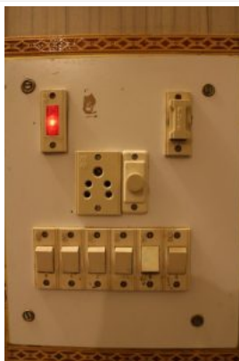
Центральная панель управления комнатным освещением (ЦПУКО)
